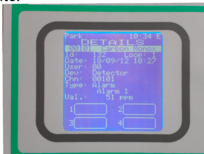
Figura 22) Dettagli evento di Allarme 1
