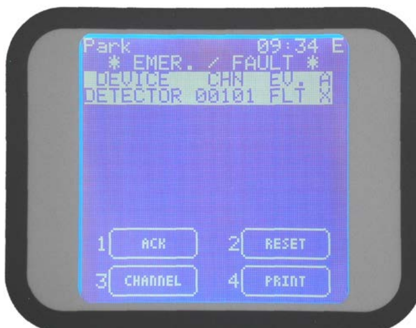
Figura 23 Videata in stato di Guasto
